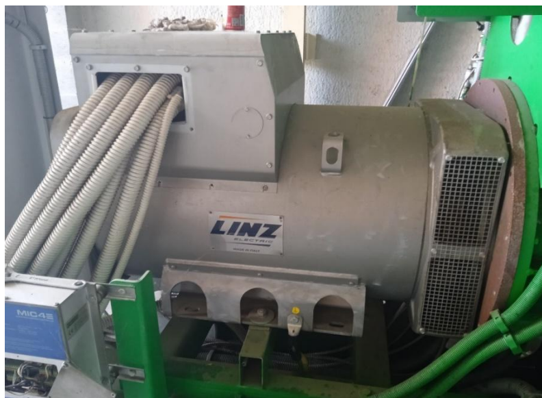
14) Generatore di corrente collegato al motore
